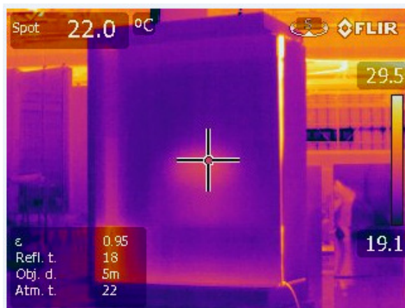
8 pav. Senos konstrukcijos izoterminės pertvaros be terminio atskyrimo termograma – sienelės sujungime su grindimis ryškiai matomas šalčio tiltas (pertvaros sujungimai su priekio siena ir stogu, krovinio tvirtinimo juosta nevertinama)
